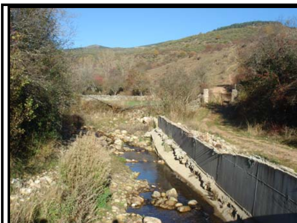
Obra de paso paralizada en río Arcillar (Neila)
