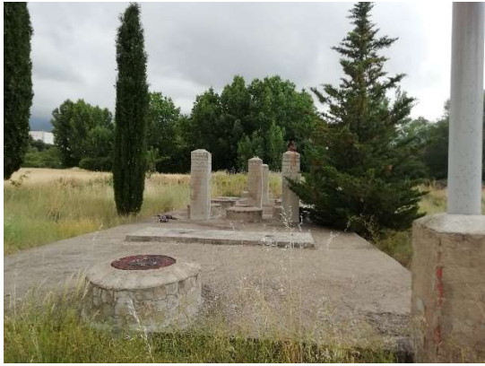
EDAR de la urbanización de Nueno.
