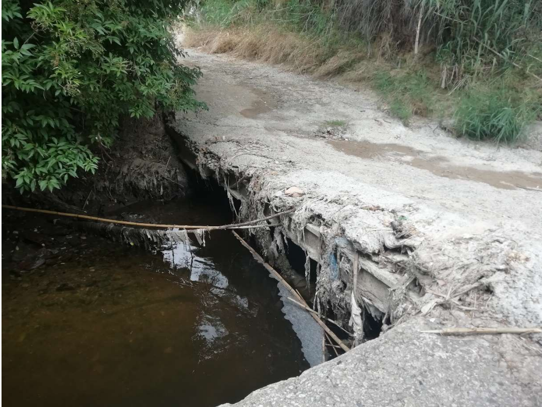
Vado para coches sobre el río Isuela (PC6). Agua turbia. Abundantes residuos.
