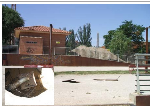
Pozo P-6 Parque San Pablo
